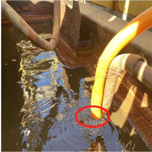
图 9 絮凝槽深度净化剂加入点
